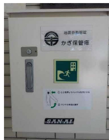
地震連動自動解錠 かぎ保管庫
