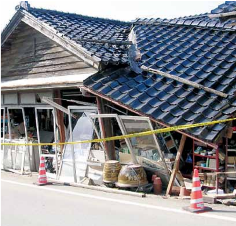
▲地震で倒壊した木造住宅
