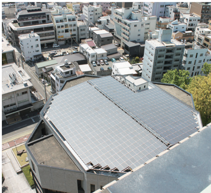
市役所南館屋上の太陽光パネル
