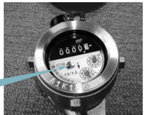
水道メーター
