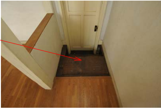
224 3階小供室（南） 出入り口段差1
