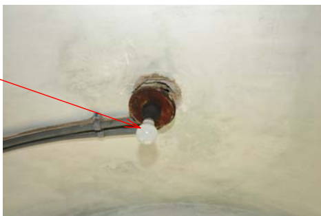
210 3階洗面室 照明
