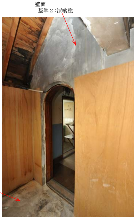
196 3階温罐室 西南向き
