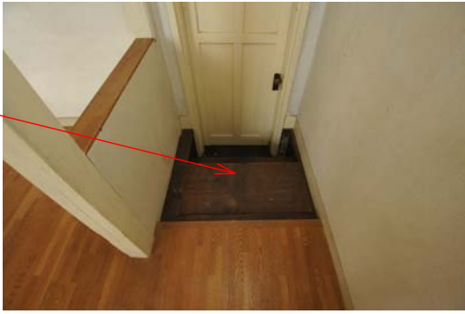
小供室(南)出入口段差
