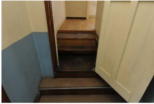
小供室(南)出入口段差
