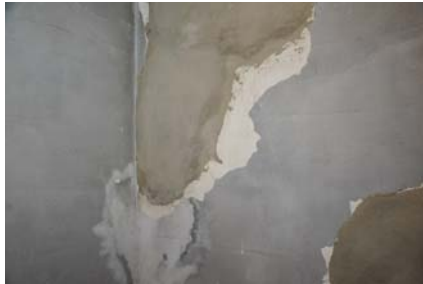
26 鼠漆喰上塗の浮き 塔屋階段室壁面の鼠漆喰上塗が浮いている。補修跡、雨染みも散見される。
