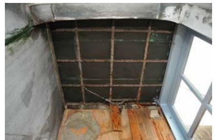
29 鉄製格子戸の発錆 塔屋への出入り口、鋼製格子戸に錆が見られる。周囲には雨染みが生じており、降雨時の恒常的な雨漏りが考えられる。
