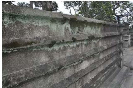
9 塀（北東）の苔 塀に苔が生じている。箇所を問わず、全体的に見られる傾向。
