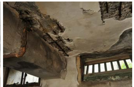
32 鉄筋コンクリート天井の爆裂 ボイラーが設置されている箇所の天井。モルタル塗が広範囲で剥落し、鉄筋が露出している。鉄筋には錆が見られる。
