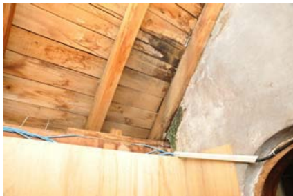
23 天井板の漏水汚損 温罐室天井南西部分に漏水による汚損が確認できる。現在も降雨時には雨が染みている状態。
