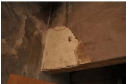
22 壁漆喰の剥落、汚損 温罐室の垂壁。雨漏りを原因とする壁漆喰の剥落と、汚損が確認できる。汚損は広範囲にわたっている。
