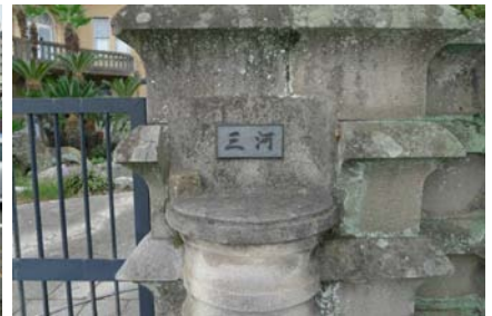
11 門柱のひび割れ 門柱石材に細かなひび割れが生じている。表札部分は新しい。
