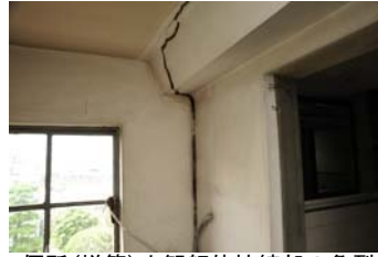
便所(増築)内観躯体接続部の亀裂 内部では、躯体の接続部に亀裂が生じていることが確認できる。
