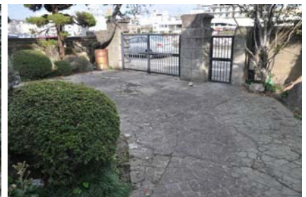
16 石敷きの不陸 樹木根の侵入や経年による劣化で石敷きに全面に渡る不陸が生じている。
