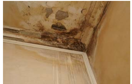
20 天井隅部の漏水汚損 階段室天井南東隅部分の漏水による汚損。コンクリートの爆裂も確認できる。現在はこの箇所からの漏水は止まっている様子。
