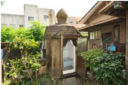
5 外部の汚損 外部が全体的に汚損している。屋根部分では縦横に亀裂が生じ、補修痕が見られる。アルミ製建具は後補。
