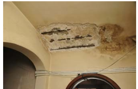
21 天井漆喰の剥落、汚損 破損「20」のすぐ南側部分。同様の破損を生じている。天井が剥落し、鉄筋が露出している。錆も確認できる。
