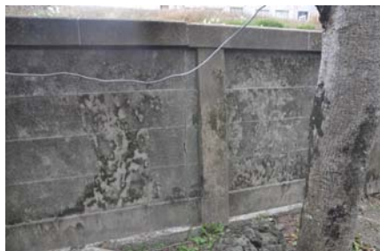
14 塀（東）の割れ 塀（東）に亀裂。頂部から下部に至る。
