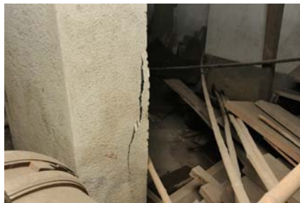
31 鉄筋コンクリート柱の爆裂 鉄筋コンクリート柱に見られる爆裂。
