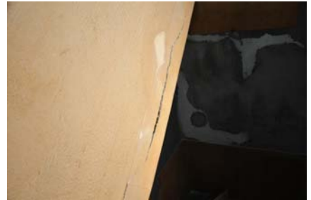
27 階段廻り部コンクリートの割損 階段廻り部コンクリートに割損が見られる。
