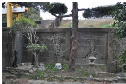
15 塀（東）の汚損 塀（東）の内側。汚れが著しい。
