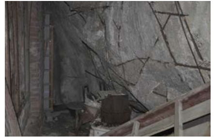
4 鉄筋、鉄網の錆 鉄筋、鉄網が露出し、錆が生じている。また、コンクリートが剥落している。
