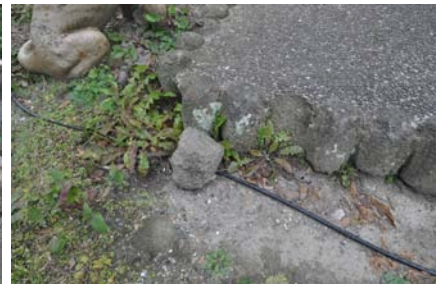
19 縁石風コンクリートの脱落 縁石風に作られたコンクリート片が脱落している。
