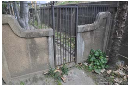
17 袖塀の門扉の破損 門扉が番線で括りつけられている。通常の開閉が出来ない状態。門扉両脇の袖塀に改修痕が確認できる。
