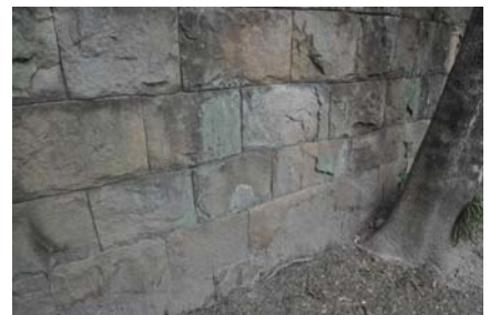
13 塀（北西）の表面剥離 塀石積み部分が粉状に風化し、表面が剥離している。苔も見られる。
