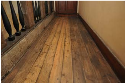
17 廊下床板の不陸 廊下床板に不陸を生じている。経年によるもの。
