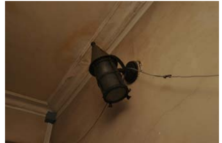
19 ブランケット照明の脱落 階段室東側に取付くブランケット照明が脱落している。経年によるもの。
