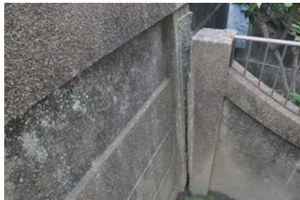
18 袖塀の破損 袖塀が塀（東）と分離している。
