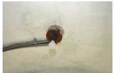
24 照明台座の脱落 洗面室照明の台座及び配線が脱落している。経年によるもの。
