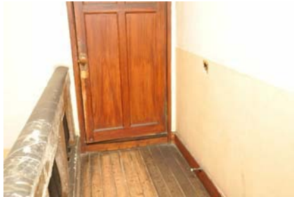
18 廊下壁面に扉金具による欠損 廊下壁面に扉金具が当って、欠損している。中木に戸当たりが取付けられているが機能していない。
