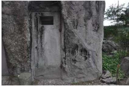
2 躯体の亀裂 外部の亀裂。躯体にまで至っていると思われる。
