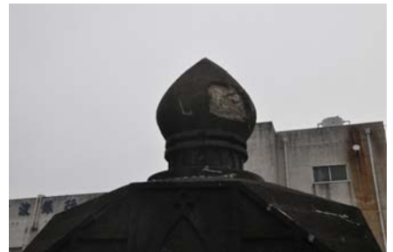
8 屋根装飾の破損 屋根頂部に載る装飾の仕上げ材モルタルが剥落し、躯体が見えている。ひび割れは装飾全体に渡っている。
