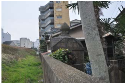
6 西側への沈下 堀が線路側（東側）へ倒れこんでおり、外便所は西側へ沈んでいる。
