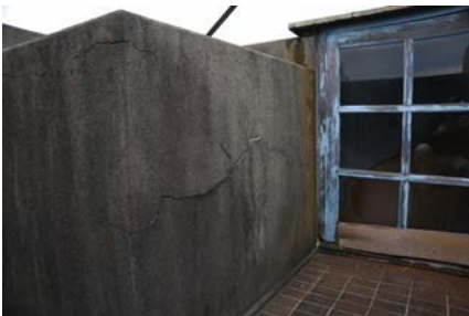
30 塔屋鉄筋コンクリートに亀裂 塔屋部に横方向に長い亀裂が見られる。亀裂は表面モルタルに生じているが、躯体にまで及んでいる可能性がある。
