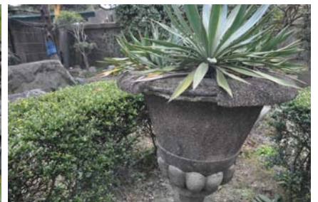
24 コンクリート製鉢の爆裂 鉄筋が腐食膨張し、コンクリートが爆裂、剥落している。
