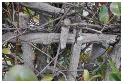
23 庭門コンクリートの爆裂 鉄筋が腐食膨張し、コンクリートが爆裂、剥落している。
