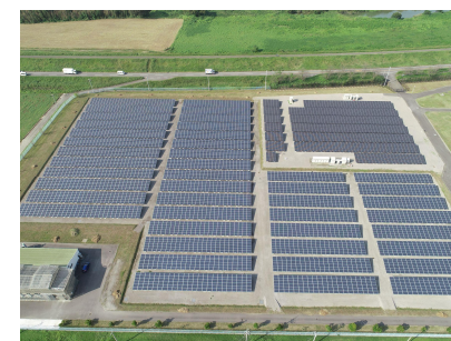
太陽光発電設備
