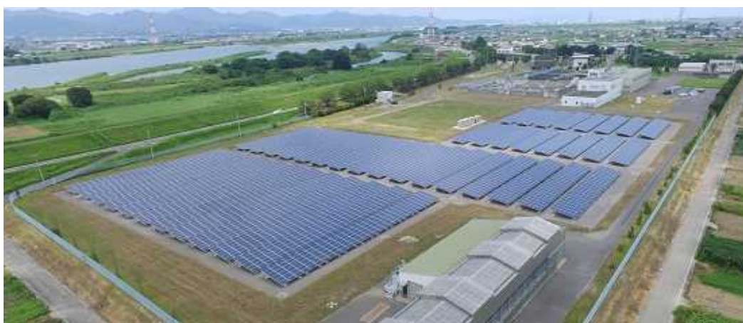
図7 太陽光発電設備（第十浄水場）
