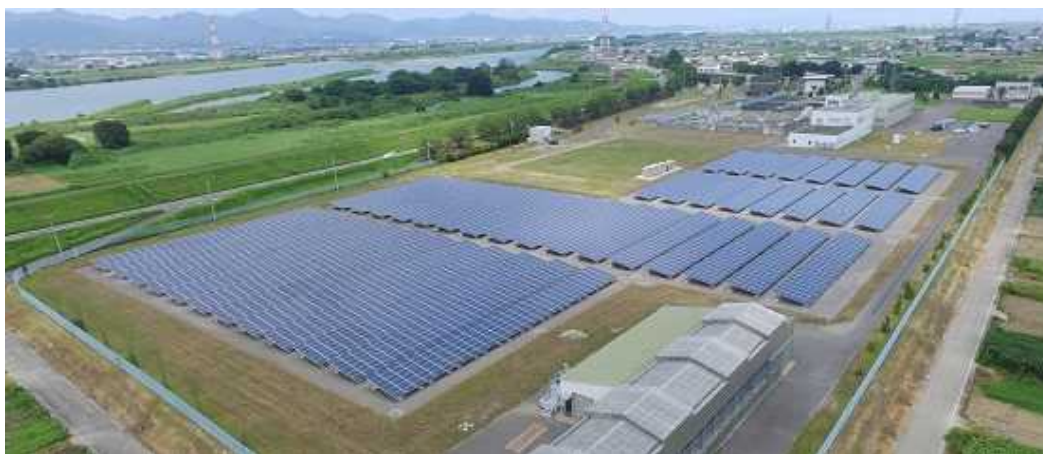
図7 太陽光発電設備（第十浄水場）
