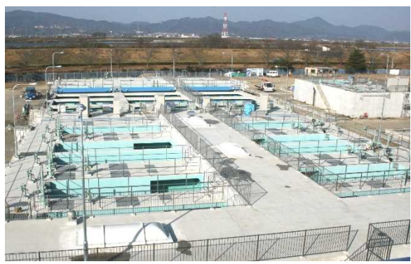
第十浄水場2系しゅん工(2010年)
