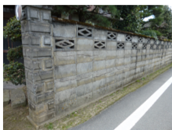
老朽化したブロック塀
