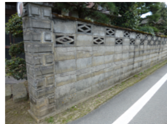
老朽化したブロック塀
