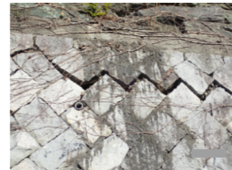
亀裂の入った擁壁・石垣
