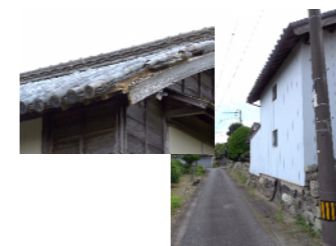
古い土葺きの屋根・道路側に傾斜した屋根
