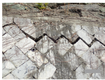
亀裂の入った擁壁・石垣
