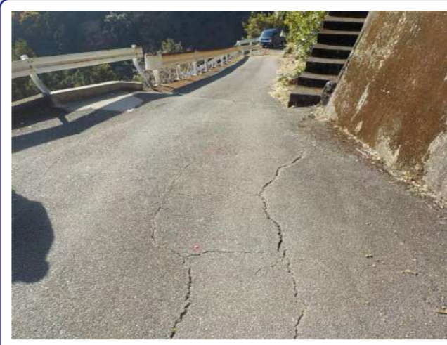
集落内の道路は地滑りの影響で亀裂が入っている場所が多い。
