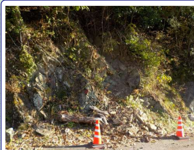
県道212号線飯谷小学校～日浦橋の区間は崩壊防止工がほとんどない。
